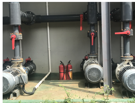
消防器材设置现场图
