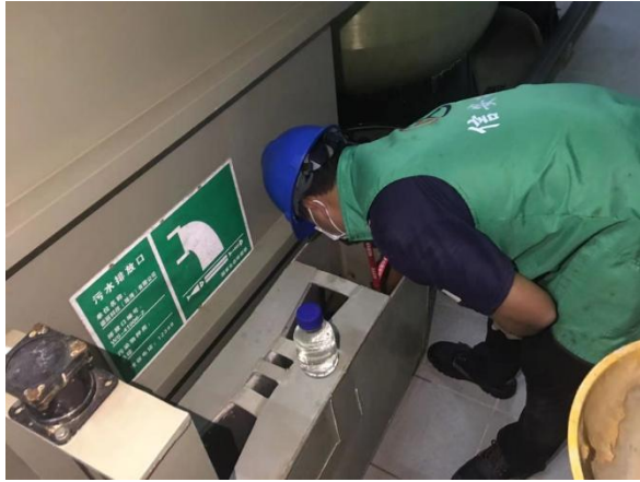
本项目车间含镍废水排放口
