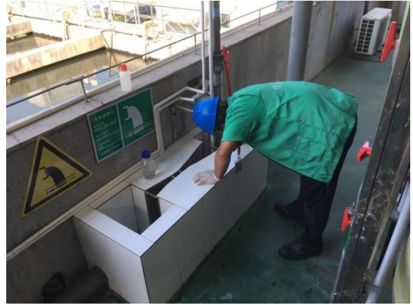
车间含银废水排放口
