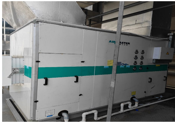
改造后的恒温恒湿风柜
