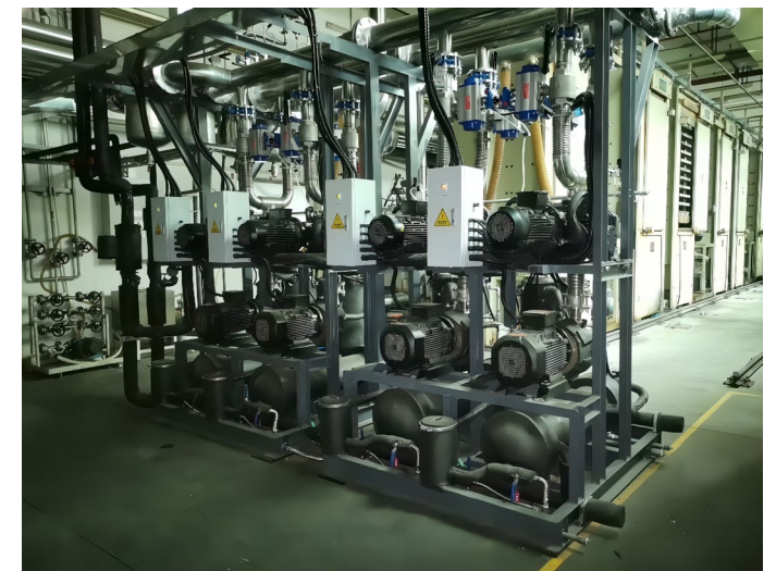
改造后的压机真空系统
