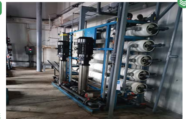
RO 浓水再利用系统
